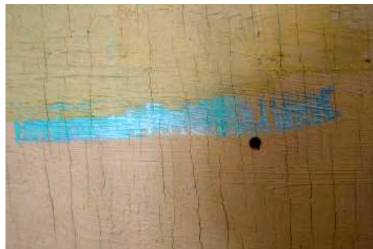
Figura 20 – Fotografia das fissuras da madeira contraplacada.
